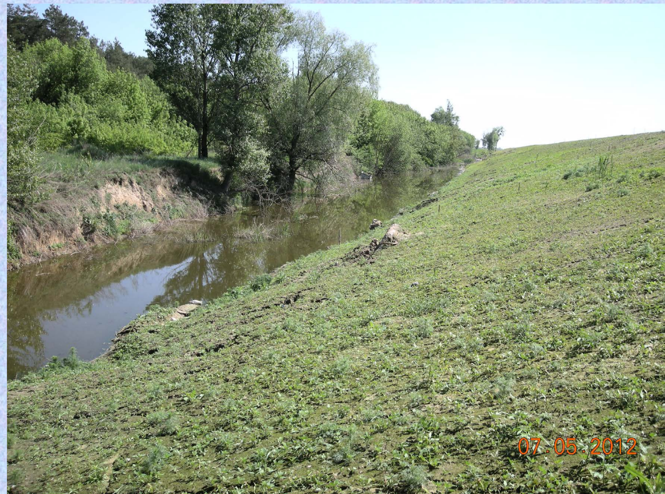
Канал відведення надмулових вод від мулового поля № 1
